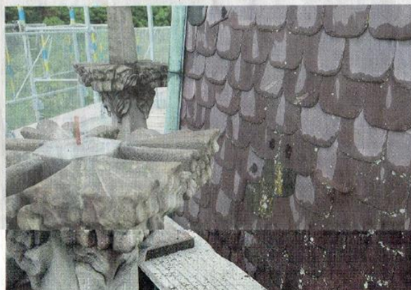
Die Witterung hat Spuren hinterlassen: Moos und Dreck haben sich an Steinfiguren und Schindeln abgesetzt.
