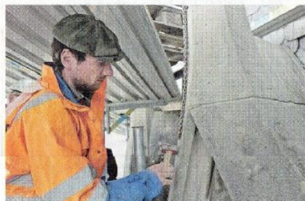
Schadensaufnahme: Steinmetz René Breuer sucht nach hohlen Stellen im Stein.
