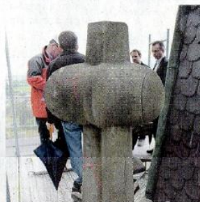
Beschädigt: Diese Sandsteinfohr hat unter der rauen Witterung gelitten.
