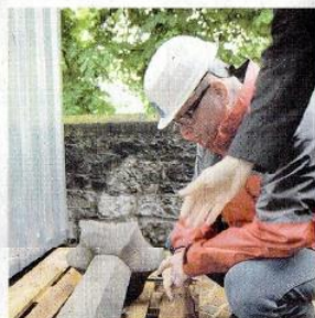
Sanieren oder ersetzen? Denkmalpfleger Patrik Birrer betrachtet die Schäden.
